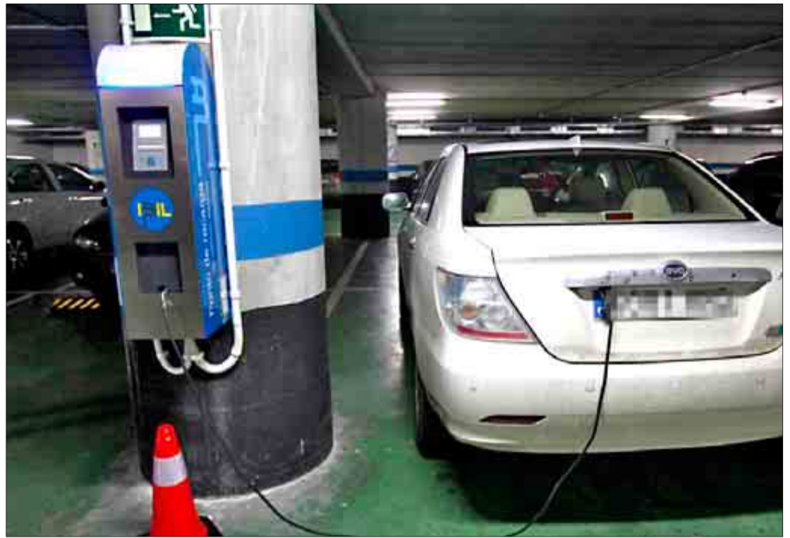
Un vehículo eléctrico recargándose en un garaje. / MITXI
