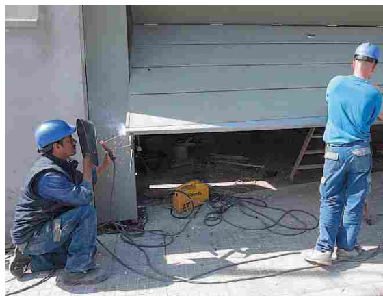
Cal mantenir les instal·lacions per evitar el seu deteriorament.
